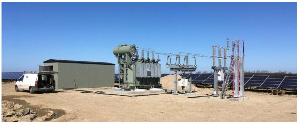
Figur 1-6 Eksempel på stepup-transformer og teknikbygning.
